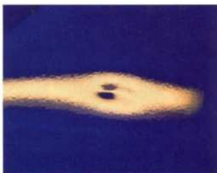
Diese Dach-Delle sitzt direkt über einer Strebe und wird deshalb von oben herausgezogen
